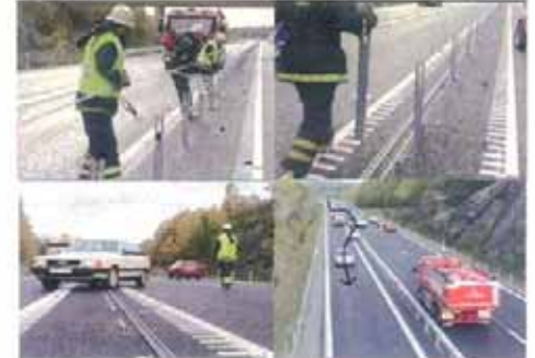
緊急時の解放 ワイヤーロープをポストから外し、ポストを引き抜く。ワイヤーロープの上を通過させ、交互通行により、交通を確保
